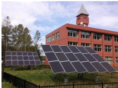
避難所に設置した太陽光発電
